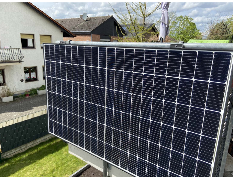
Montierte Stecker-PV-Anlage an einem Balkon.
